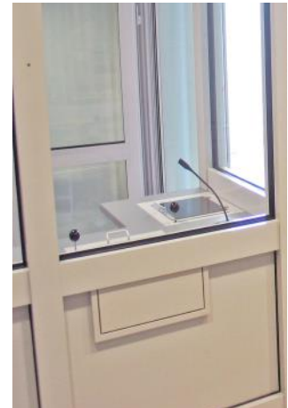
Eingebaute Schiebemulde, flächenbündig mit der Trennwand.
