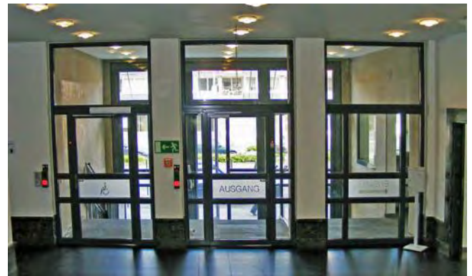
Ausgangsschleuse eines Gerichtes mit Fluchttürsteuerung. Stahlrohrrahmenkonstruktion.
