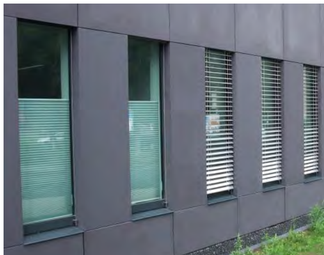
In den beiden linken Fenstern sind die Jalousien im Glas, in den rechts daneben angeordneten Fenstern sind sie außen vor dem Fenster installiert.
