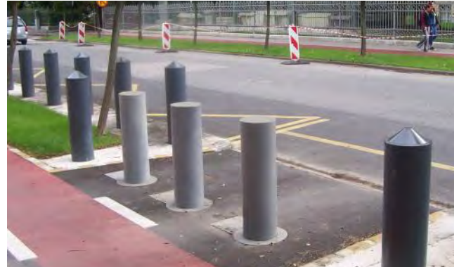
Hydraulisch versenkbare und fixe Poller wurden in diesem Projekt kombiniert.
